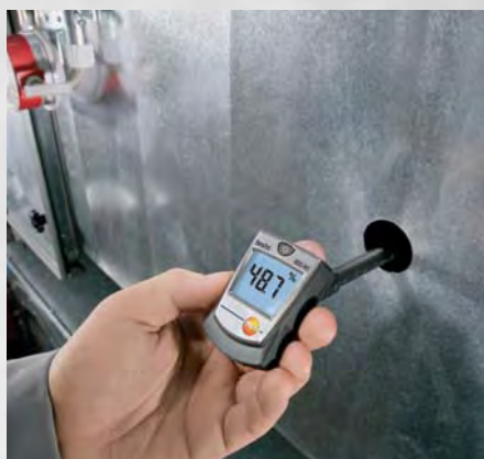
Kontrola vlhkosti vzduchu v klimatizačním kanálu.
